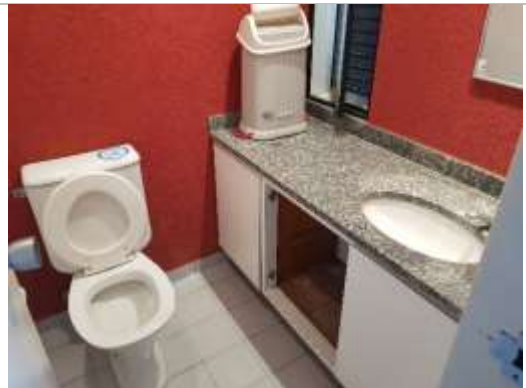
Sanitário interno nos conjuntos
