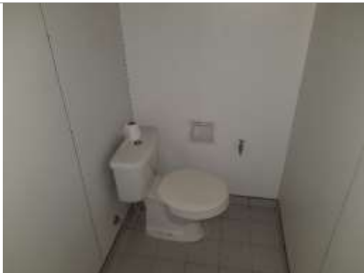
Sanitário interno nos conjuntos
